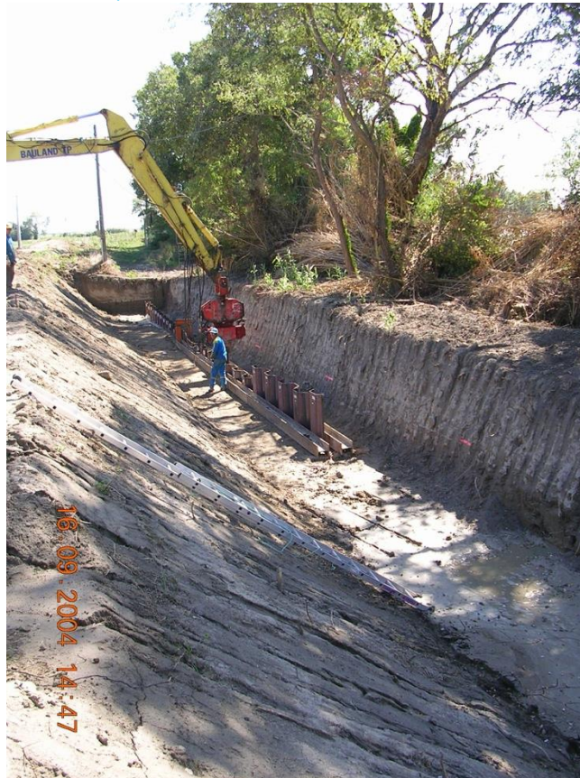
Figure 3.4 : Réalisation d'un rideau de palplanches pour étanchéité en fondation côté eau d'une digue, destiné à être surmonté d'un remblai argileux pour étanchéité du corps de digue (Photo : R. Tourment)
