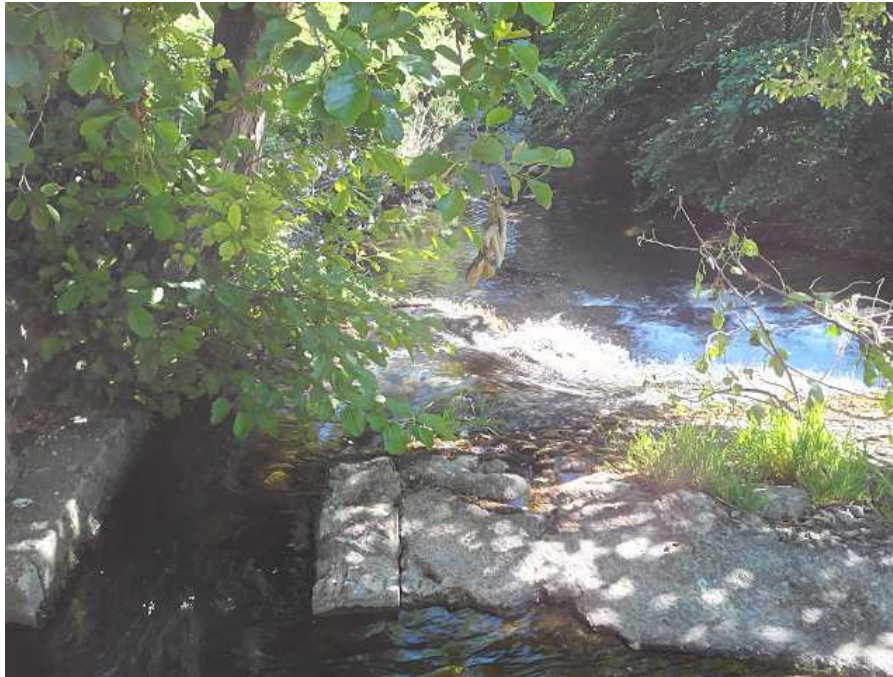
FIGURE 5.6 – Échancrure dans le seuil de dérivation (Canal du Prat-Pialoux)
