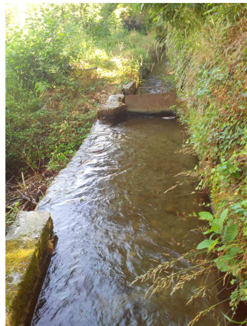
FIGURE 11.112 – Photo du seuil de décharge et de la vanne de régulation du débit prélevé par le canal situés plus de 250 m en aval de la prise d'eau (vue amont)
