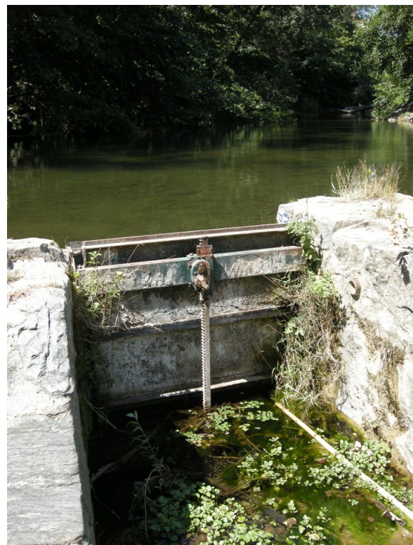
FIGURE 4.20 – Photo de la vanne de restitution du débit réservé du canal de la plaine
