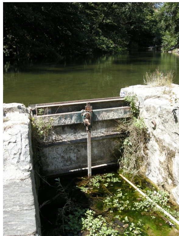
FIGURE 11.93 – Photo de la vanne de restitution du débit réservé du canal de la plaine
