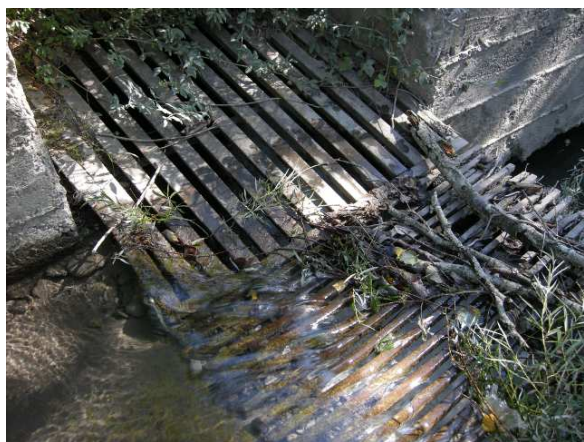
(a) Vanne prise d'eau
