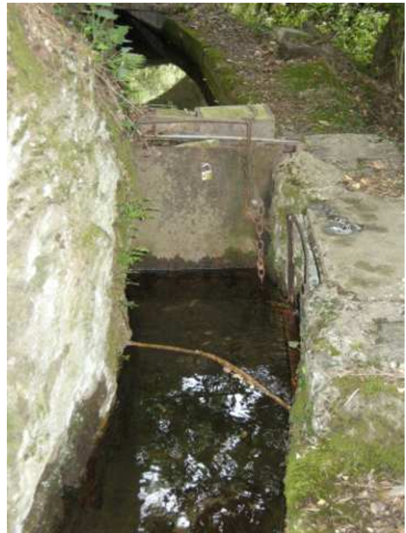
(b) Vanne de régulation du débit prélevé et seuil évacuant le surplus prélevé en tête
