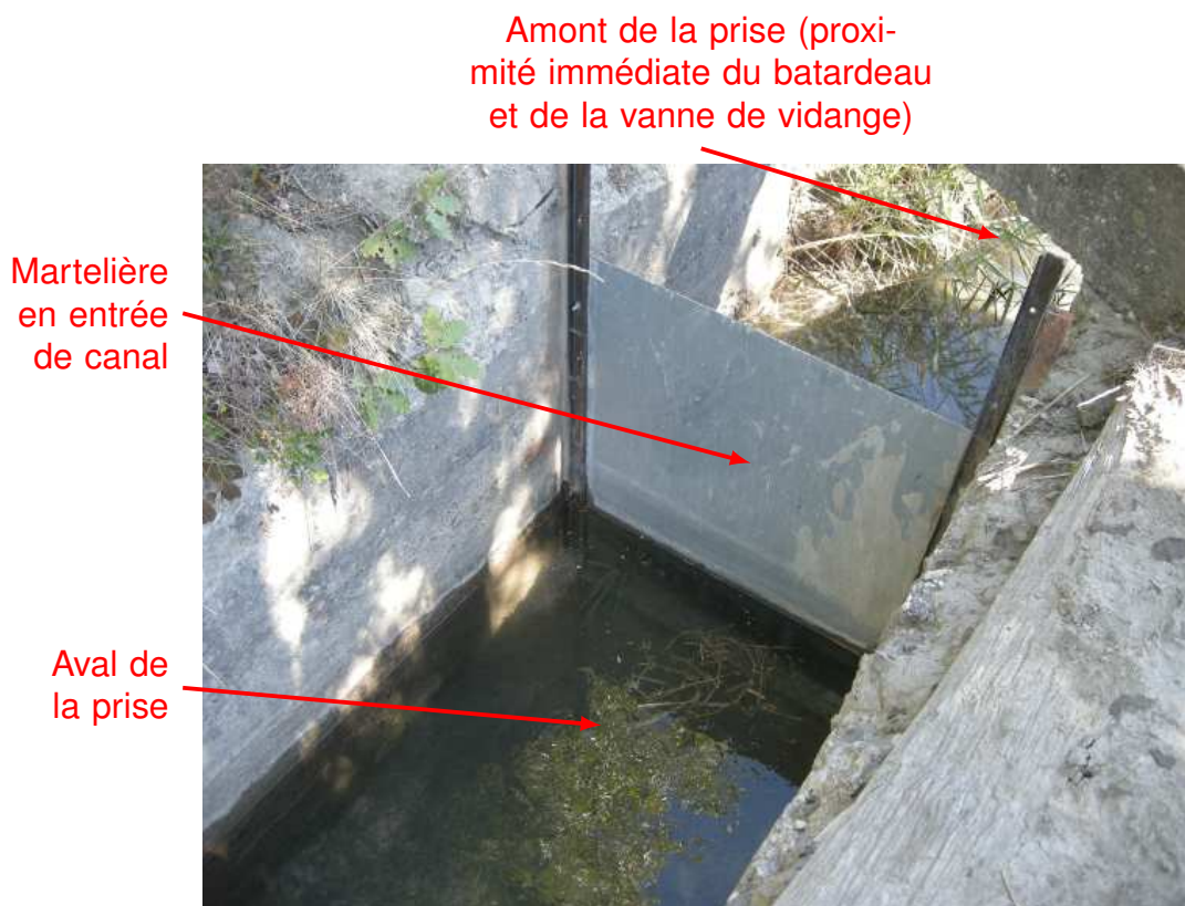
FIGURE 4.6 – Photo de la prise d'eau Canal du Moulin : vanne à l'entrée du canal
