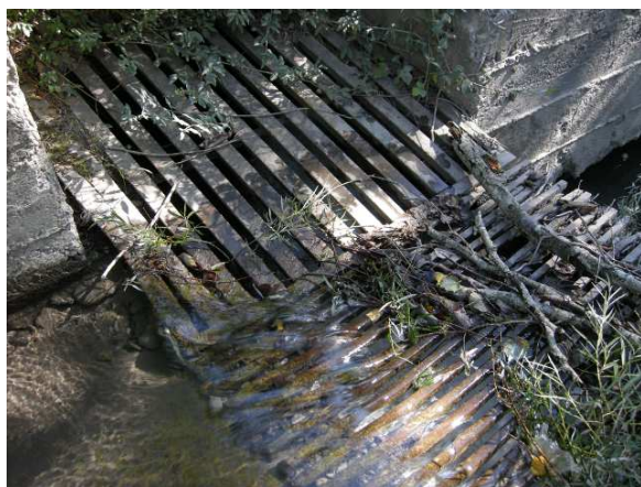
(a) Vanne prise d'eau
