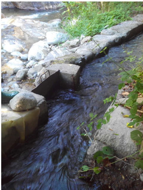
FIGURE 11.111 – Photo de la vanne de décharge du canal du bac de joncet située quelques dizaines de mètres en aval de la prise d'eau
