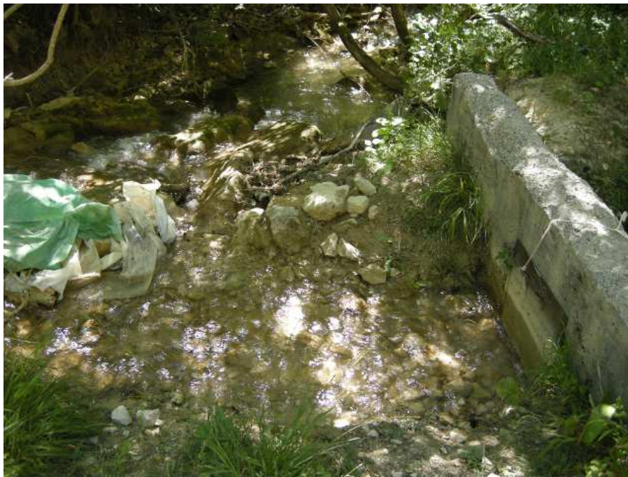
FIGURE 11.21 – Photo du seuil de dérivation du canal de Gion (vue de la rive droite)
