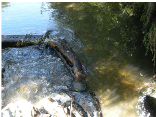
FIGURE 11.129 – Photo de l'échancrure en rive gauche du cours d'eau
