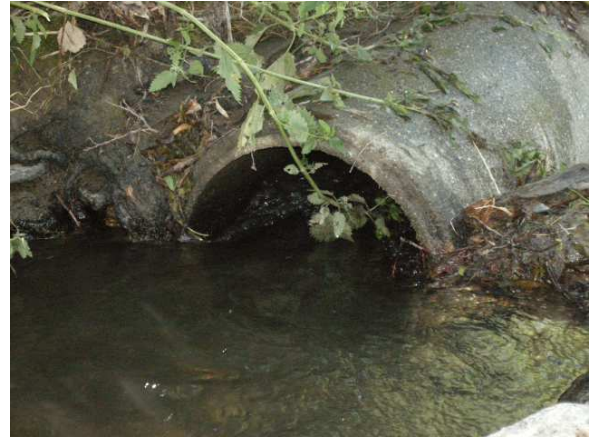
(b) Buse en entrée de canal
