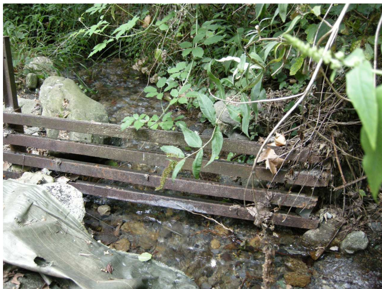
FIGURE 11.117 – Photo du canal de l'Évol et de la prise d'eau du canal (vue amont)
