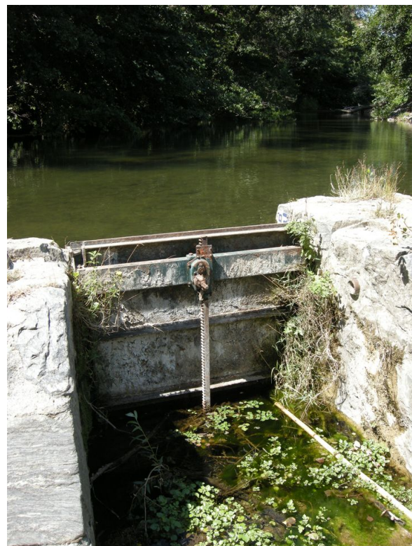
FIGURE 4.20 – Photo de la vanne de restitution du débit réservé du canal de la plaine
