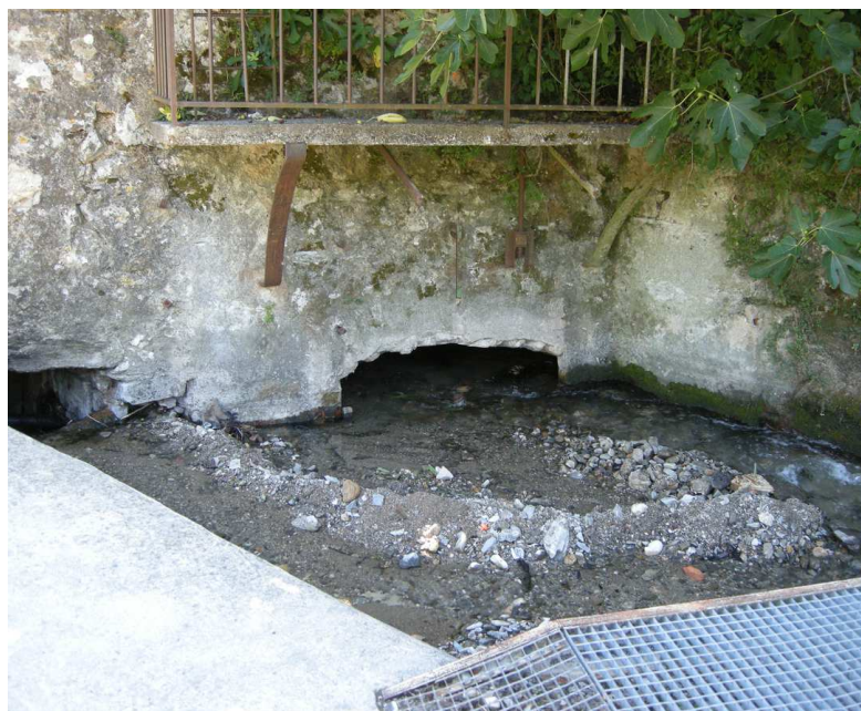
FIGURE 11.58 – Photo de la prise d'eau du canal de saint Hippolyte
