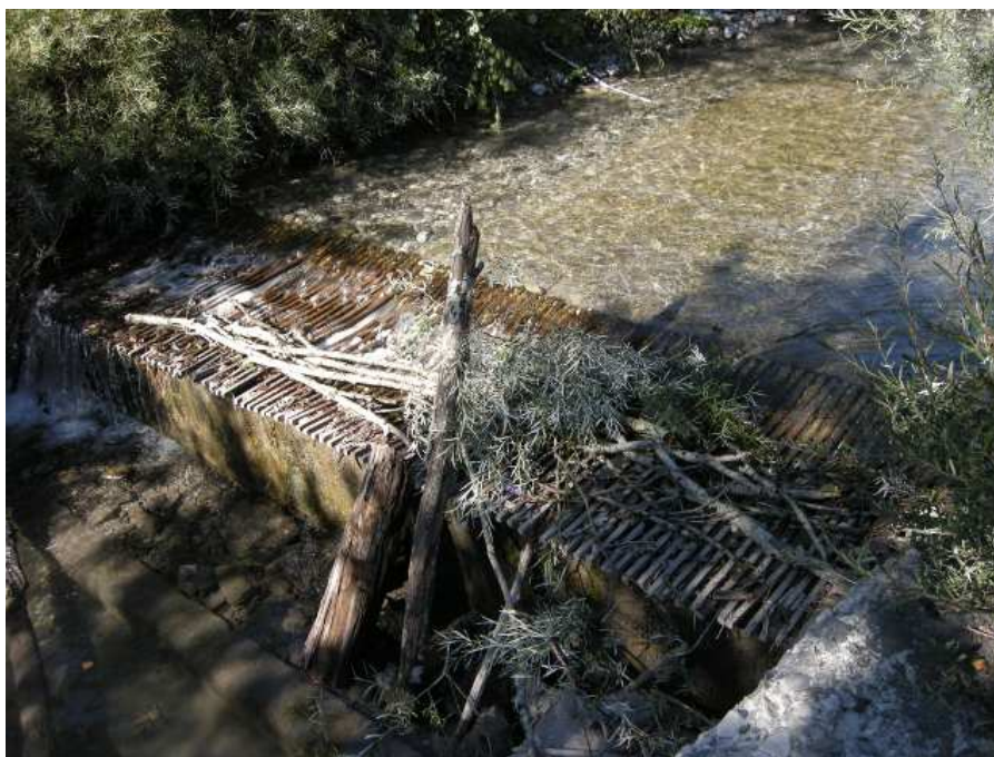
FIGURE 5.13 – Prise d'eau par en dessous du canal du bourg (04)
