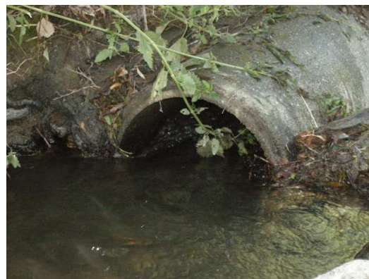
FIGURE 11.130 – Photo de l'amont de la buse après l'échancrure
