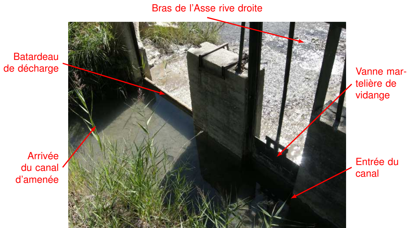
FIGURE 4.5 – Photo de la prise d'eau Canal du Moulin : batardeau et vanne de vidange
