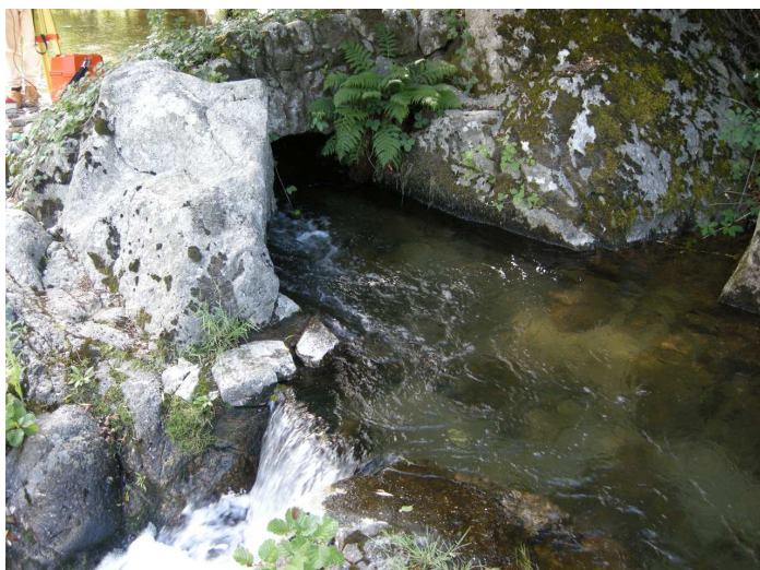
FIGURE 11.48 – Photo de la vanne de décharge du canal et de l'arrière de la prise d'eau du canal de cambon
