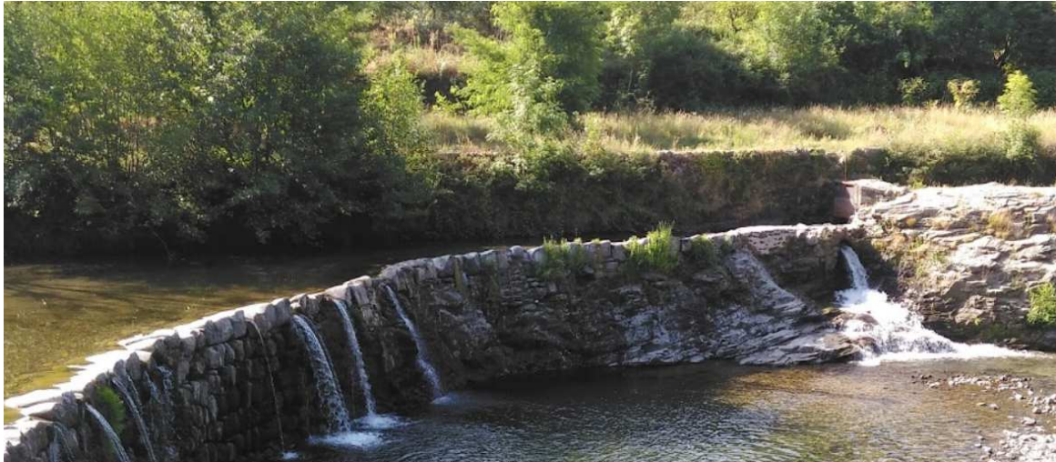
FIGURE 5.8 – Orifice dans le seuil de dérivation du Canal du Prat (Crédit photo : Emmanuel Delagarrigue)
