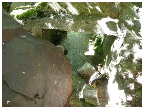
FIGURE 11.64 – Photo de la vanne de controle du canal de Callière (vue amont)
