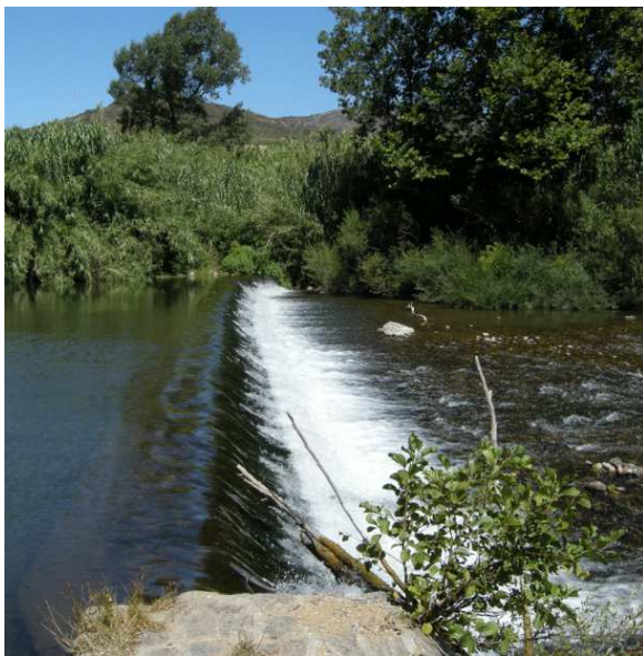
FIGURE 4.19 – Photo du seuil de dérivation du canal de la plaine (vue depuis le canal)
