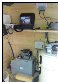
Illustration 3 : Instrumentation du site de Chantemerle, seuil déversoir à la sortie du collecteur de drain et abri avec l'interface.
