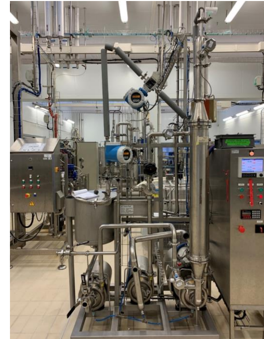
Pilote plateforme STLO Tetra Alcross MFS-7, TetraPak Filtration System
