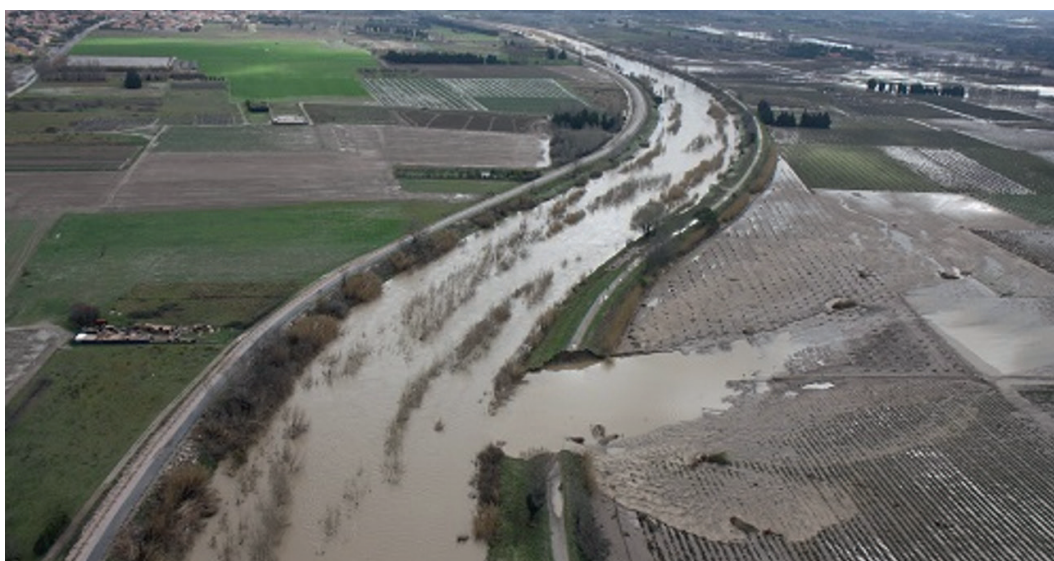
Figure 9.8 – Brèche de 1999 sur les digues de l'Agly / © DREAL Occitanie
