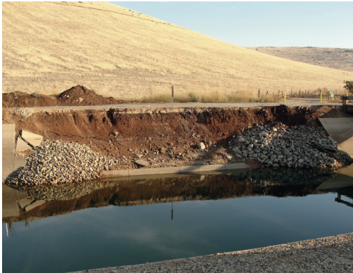
Figure 7.10 – Canal de Friant Kern (USA, photo 2012) – Rupture type de la dalle de protection en béton de la berge due à la présence de sols gonflants / @ Lhoist
