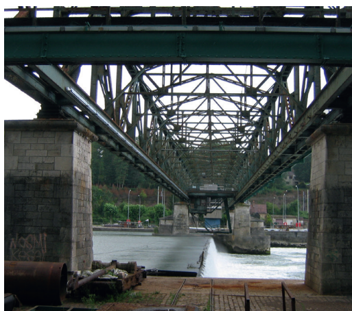
Figure 8.11 – Ancien barrage en fonction depuis 1928, muni de hausses Aubert / © Artelia
