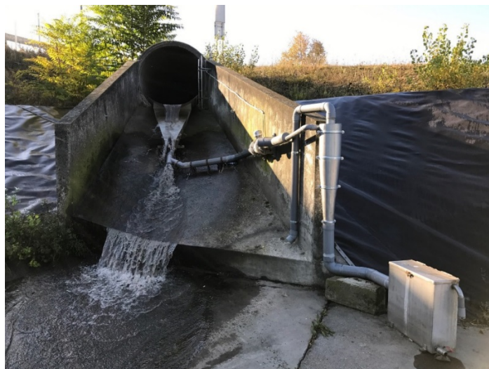
FIGURE 1. DISPOSITIF D'ÉCHANTILLONNAGE DES SÉDIMENTS À L'ENTRÉE DU BDR (DISPOSITIF COMPOSÉ D'UN LEAPING WEIR, HYDROCYCLONE ET UN CAISSON DE PIÉGEAGE DE SÉDIMENT).
