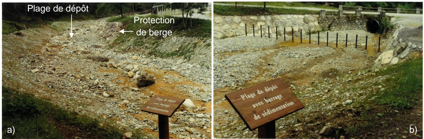
Figure 4 : Photographies du piège à flottants de Rochebillière lors de sa construction en 1997 – a) vue vers l'amont et la plage de dépôt. Une protection de berge a été mise en œuvre en rive gauche de la plage de dépôt pour protéger la route du cimetière. b) vue vers l'aval, le piège à flottant et la buse à protéger en aval. Les berges autour du râtelier ont aussi été protégées contre les érosions par des encochements liaisonnés au béton (Source : ONF-RTM 06)
