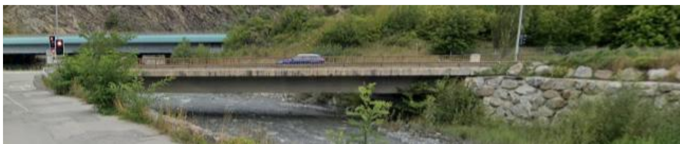
Figure 5 : Pont de la RD1006 vu depuis l'amont, le viaduc de l'autoroute A43 passant sur l'Arc est visible au fond de la photo (source : GoogleStreetView)
