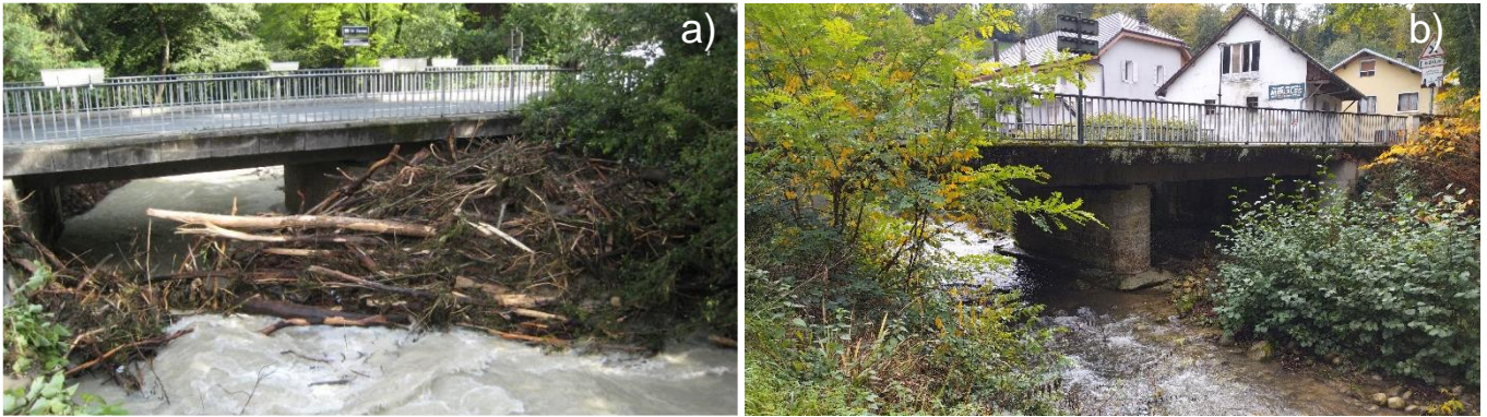
Figure 2 : Pont de la RD911 à l'entrée de de Grésy-sur-Aix, a) vue d'amont après la crue du 10 juin 2008 (source : CISALB, 2018) et b) vue d'aval le 25 octobre 2022 en condition d'écoulement normal.
