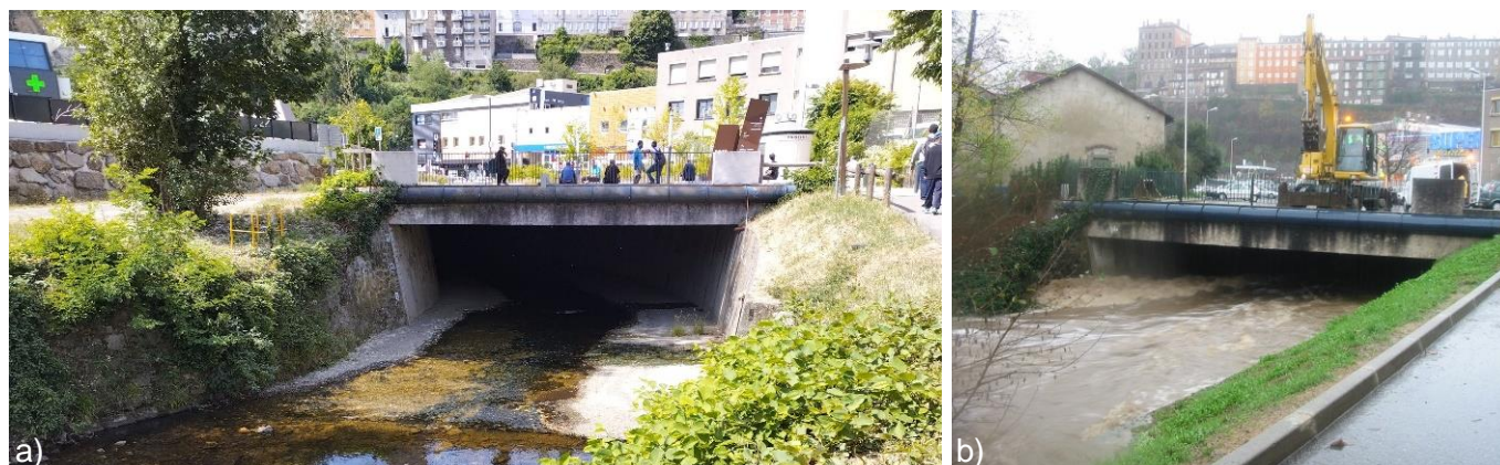
Figure 1 : Amont du passage couvert de la Déûme à travers le centre-ville d'Annonay : a) à l'étiage en Mai 2022 ; b) lors d'une crue de période de retour sensiblement vingtennale le 02/12/2003 (source : Syndicat des 3 Rivières)
