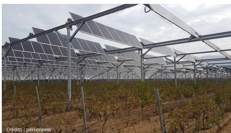
Figure 23 : Photographie du système agrivoltaïque
