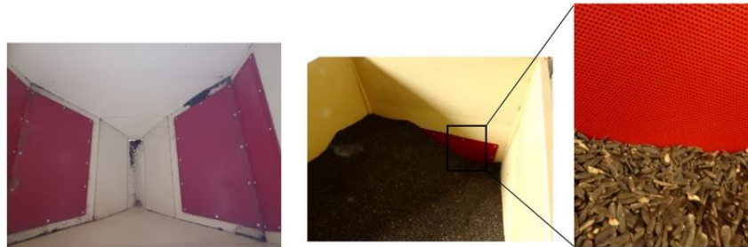
FIGURE 9 – Plaque perforée présente dans le caisson
