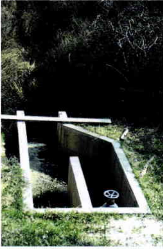
Pêcherie extérieure bétonnée (3 x 2 m) avec vanne de vidange en sortie de buse, sur un petit étang (1 ha), Dordogne. (Ph © Schlumberger/Cemagref)
