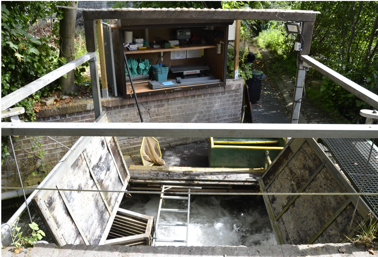
Figure III.29. Vue du piège de montaison d'Eu pour les salmonidés en fonctionnement.
