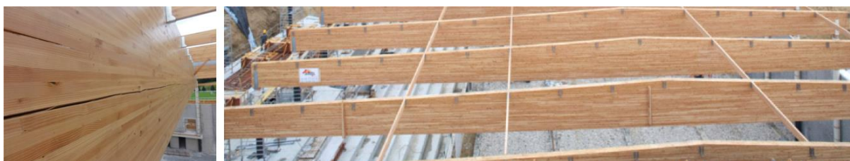
Fig. 9 : Fissuration de retrait hydrique sur charpente lamellé-collé
