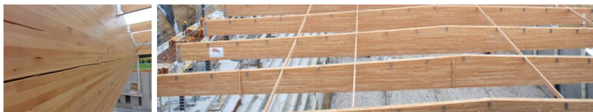
Fig. 9 : Fissuration de retrait hydrique sur charpente lamellé-collé
