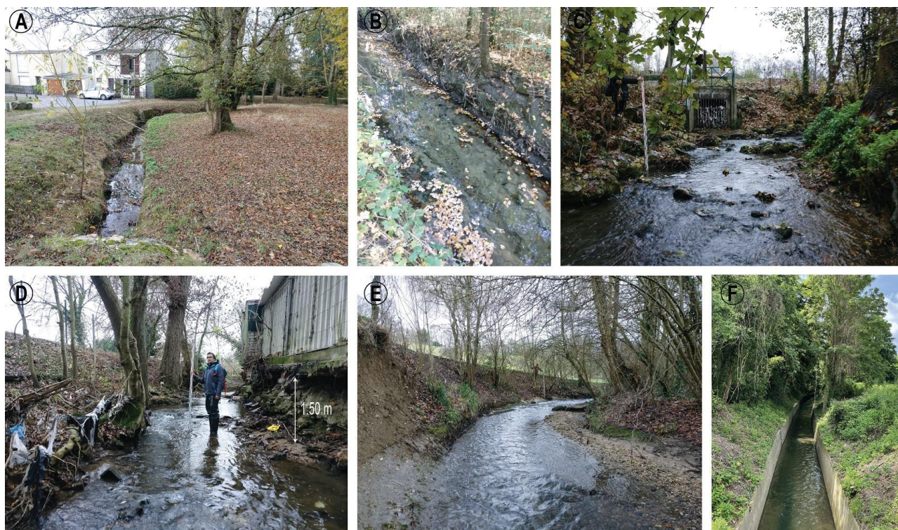
Figure 2. Photographies de six secteurs du Morbras. A : marque d'érosion latérale ; B : bedrock argileux apparent ; C : rejets caractéristiques des eaux pluviales identifiés sur le Morbras (>1 m) et blocs ; D : incision et sapement d'un bâtiment ; E : érosion latérale ; F : Section canalisée.
