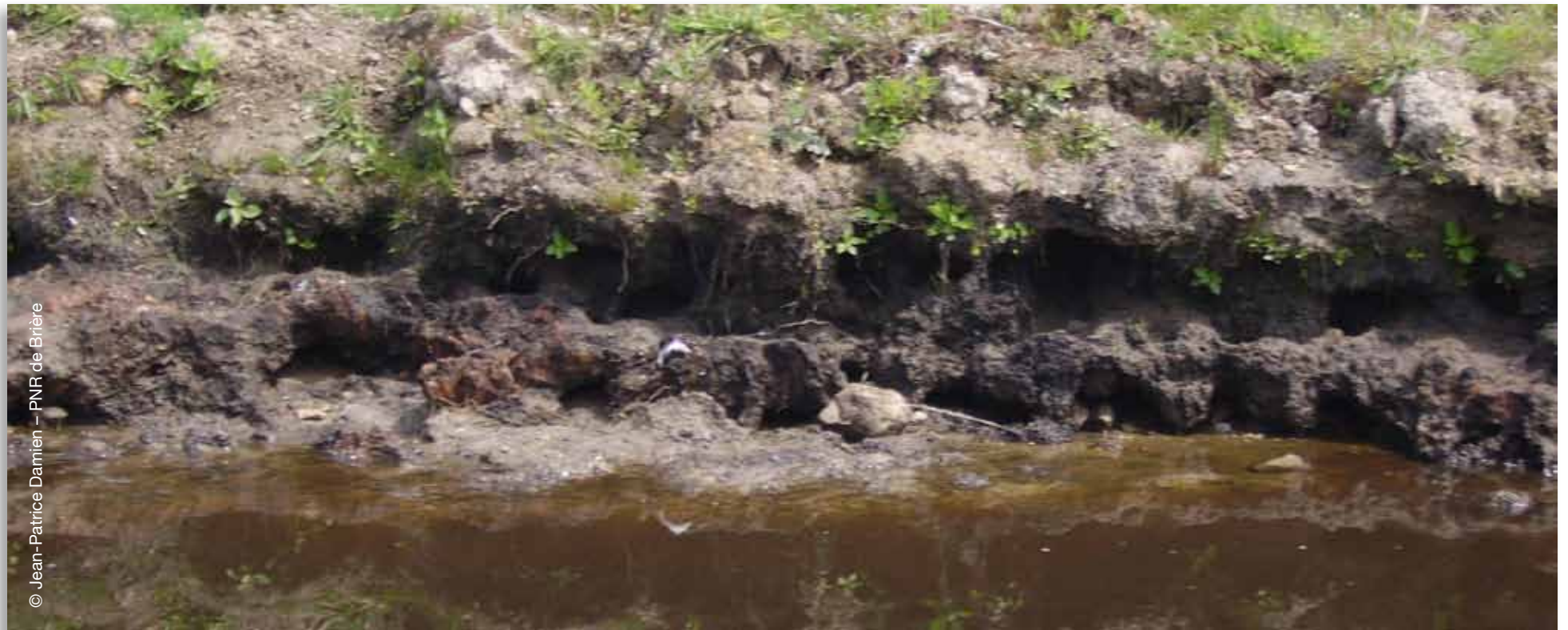
Berge de canal, en Brière, endommagée par de nombreux terriers d'écrevisse de Louisiane
