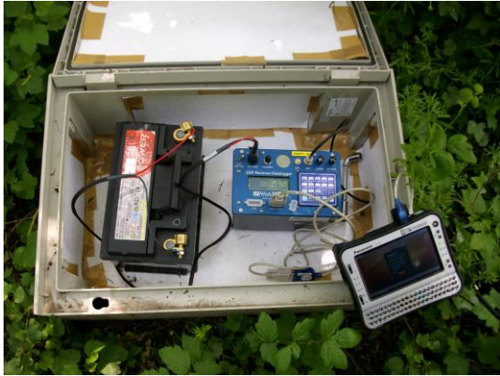
Figure 57 – Coffret fixe de détection et d'enregistrement comprenant le boîtier récepteur ATS et une batterie d'alimentation. Une antenne filaire sort du coffret et son extrémité est plongée dans le cours d'eau.
