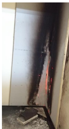
Fig. 7 : Panneau Alumine Zircone à la fin des essais SBI de réaction au feu.
