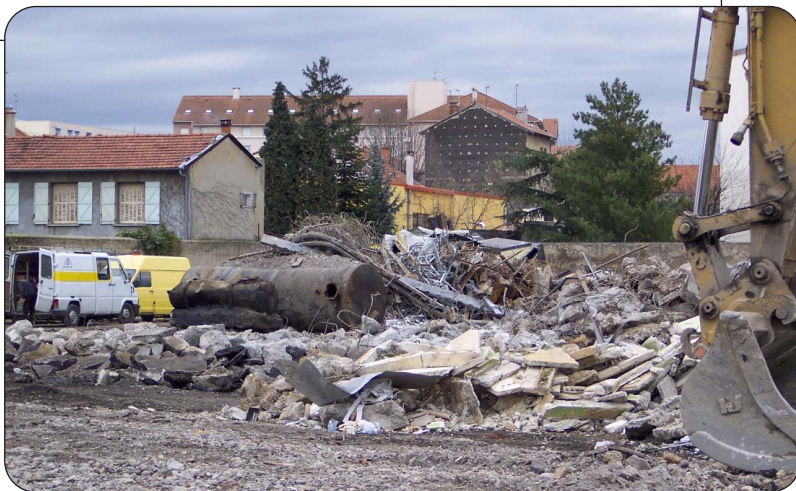
Figure 2.1. Découverte fortuite – par manque d'études préalables – d'une cuve enterrée contenant du fioul résiduel avec pollution des sols périphériques par des hydrocarbures lors des travaux de démolition d'anciens bâtiments industriels en zone urbaine
