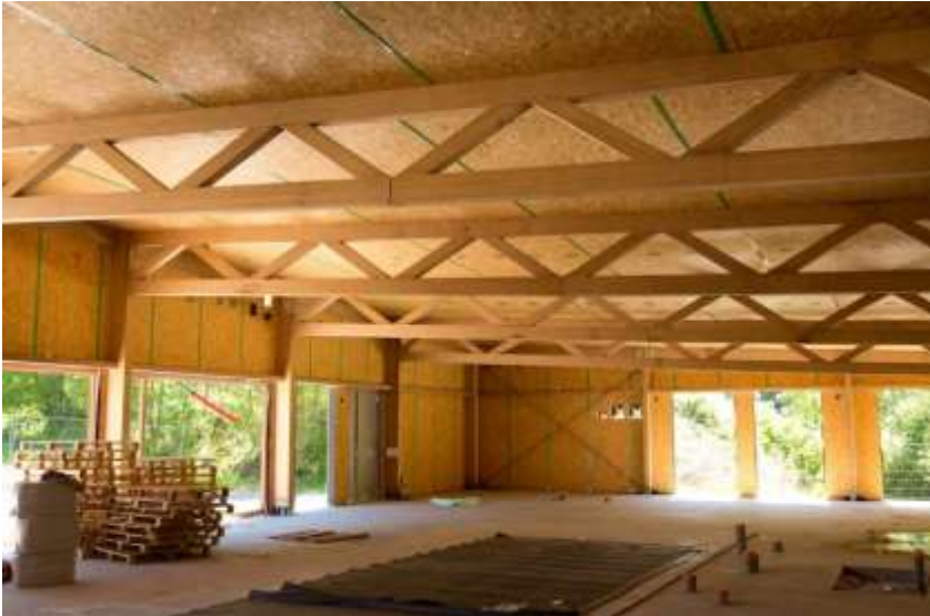
Photo 4 : Structure en lamellé collé de hêtre de l'atelier bois, lors de la construction (Photo de J.F. Hamard)
