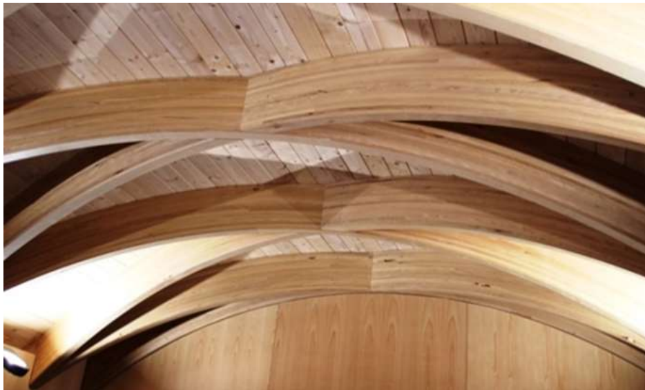
Photo 2 : Charpente en mix hêtre (structure) – épicéa (parement) de la structure d'accueil des habitations de loisir, à Xertigny (Photo de Q. Remy)
