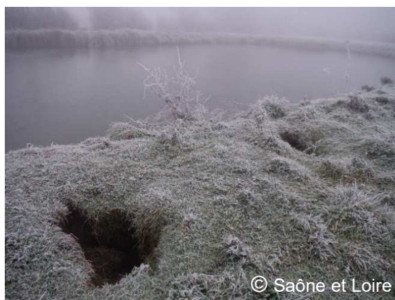
Figure 16 : Exemple de dégâts occasionnés sur les berges d'une lagune par des ragondins
