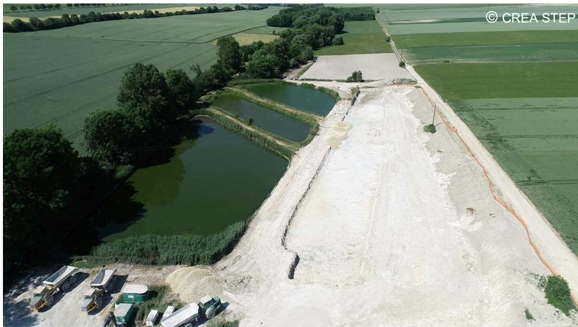
Figure 24 : Augmentation de la surface des lagunes par création d'un 4 ème bassin (à droite, en cours de construction)
