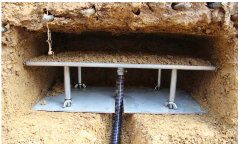
Lysimètres à mèche en cours d'installation. La plaque est ensuite mise en contact avec le sol
