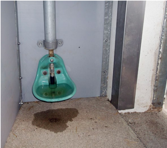
Photo 2.1 | 3: Les abreuvoirs peuvent être installés à une hauteur qui convienne à la truie et aux porcelets.
