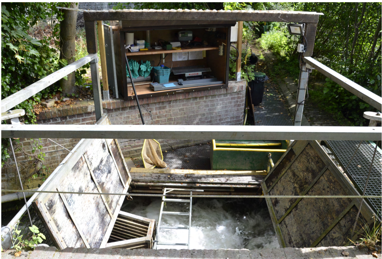
Figure III.33. Vue du piège de montaison d’Eu pour les salmonidés en fonctionnement.
