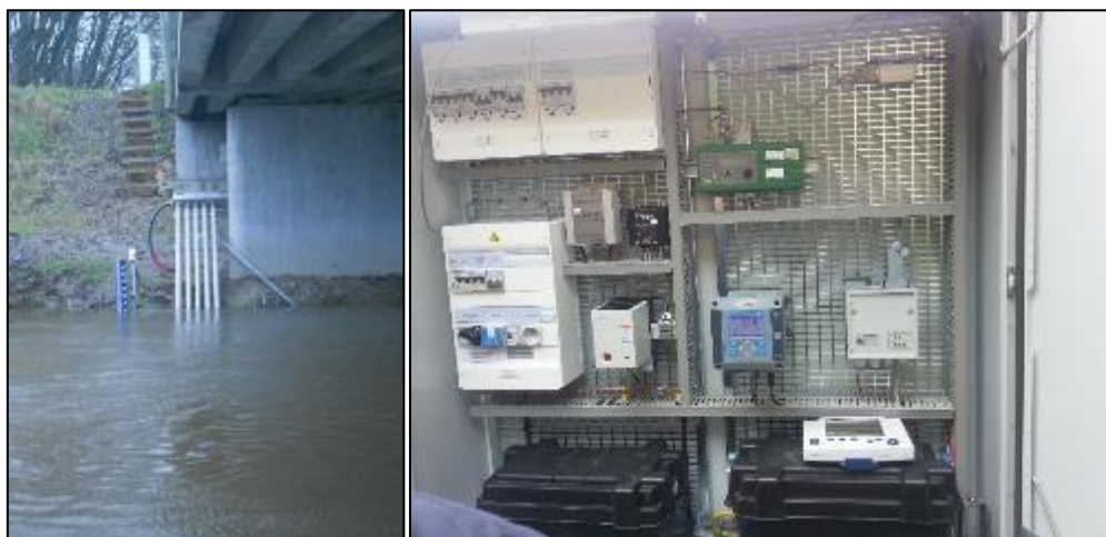
Figure 3 Station INRAE-EDF du pont de Virey (amont) ; gauche : support des sondes multi-paramètres ; droite : installation électrique avec la centrale d'acquisition, les différents capteurs et les batteries.
