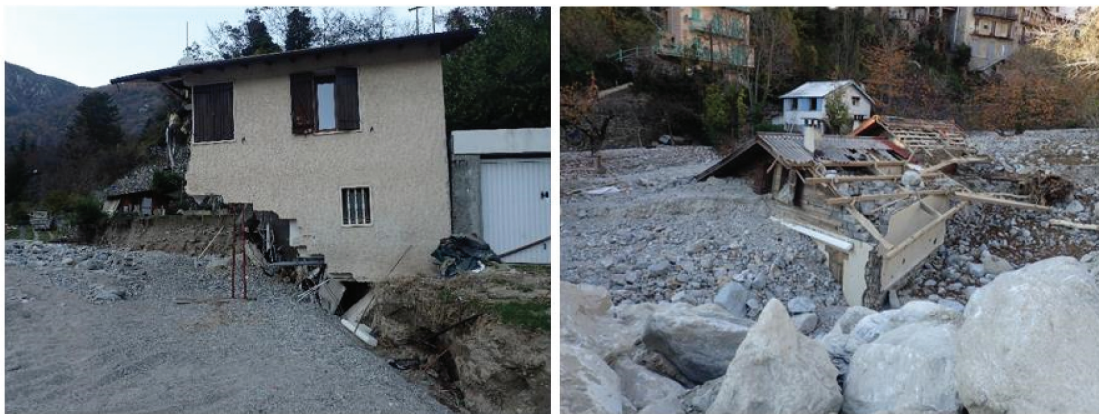
Figure 6. Exemple d'état de bâtis levé pendant le terrain post évènement : (gauche) St Dalmas de Tende, dommage important par affouillement d'intensité forte, y compris localement au niveau des fondations (source : ONF-RTM) ; (droite) St Martin Vésubie, dommages importants par engrèvement d'intensité forte sans affouillement des fondations (source : ONF-RTM).
