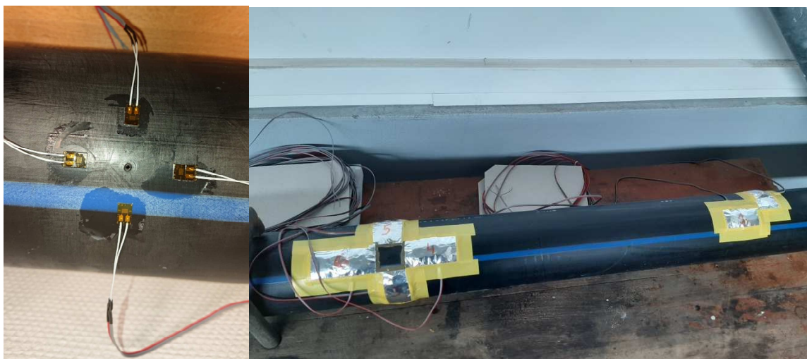
FIGURE 10 : JAUGES DE CONTRAINTE AVANT (A GAUCHE) ET APRES (A DROITE) IMPERMEABILISATION
