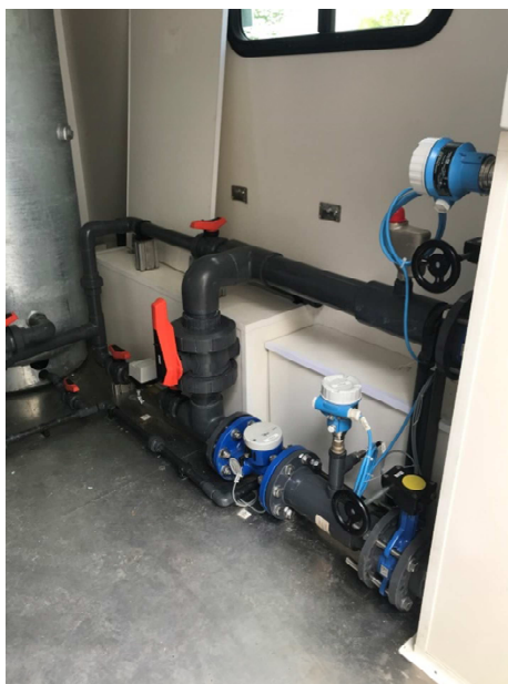
FIGURE 34 : CANALISATIONS ET APPAREILS DE MESURE
