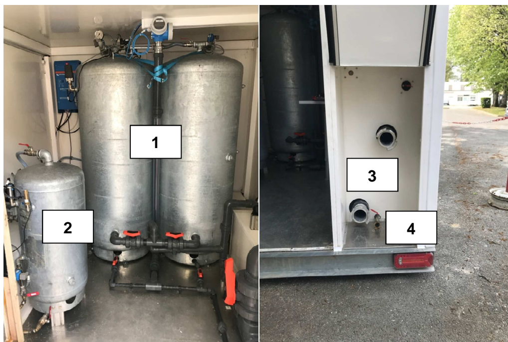
FIGURE 33 : CUVES (1), SYSTEME DE REGULATION DE PRESSION (2), ENTREE ET SORTIE (3) ET PURGE (4) DU CIRCUIT D'EAU
