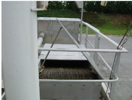
Photo : dégrilleur automatique
