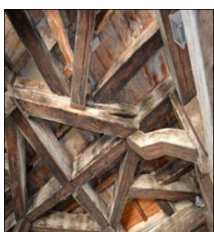
Fig. 5 : Illustration de l'endommagement mécanique dans des poutres portant le rez de chaussée
