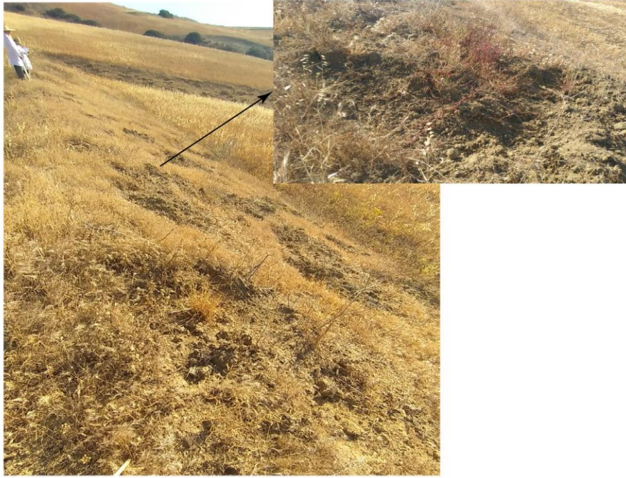
Photo 16- Écroulement superficiel du talus de la banquette (AMRI S., juin 2022)
