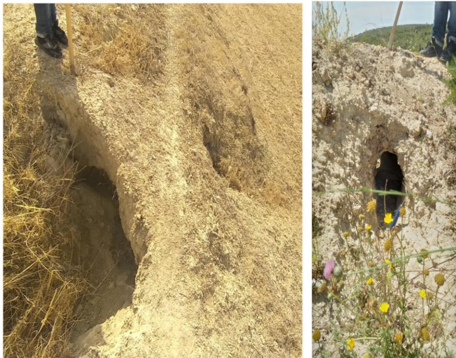
Photo 19- Banquette affectée par des tunnels (AMRI S., juin 2022)
