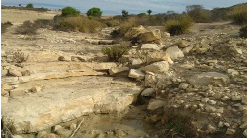
Photo 10- Recul en escalier au niveau du cours d'eau principal (AMRI S., juillet 2022)
