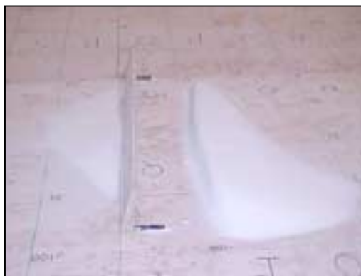
Photographie 20 : dépôt autour d'une barrière.
