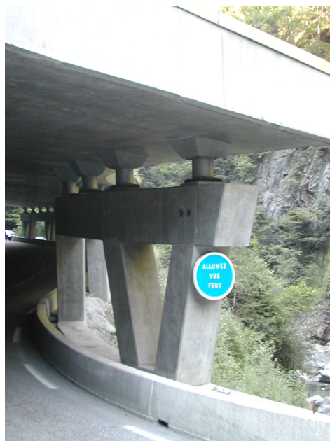
Fig. IV. 4 – Fusibles entre la structure porteuse et la dalle – Galerie des Essariaux (PBR).
