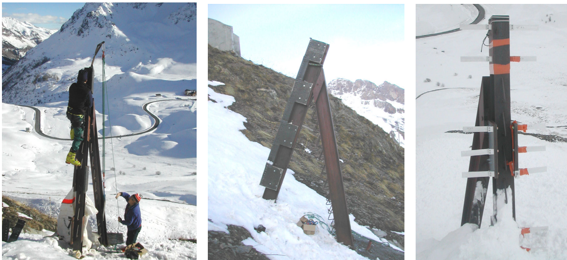
Fig. V. 16 – Transformation du tripode, tripode reconfiguré et sommet du tripode équipé après une avalanche (PBR)
