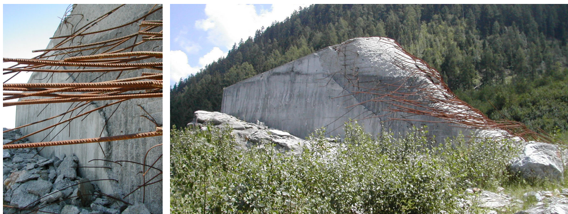
Fig. IV. 70 – Béton d'enrobage arraché et armatures peignées (PBR)
