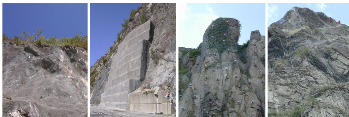
Fig. II. 17 - Défense permanente active pare-blocs : béton projeté, contreforts, ancrages-emmaillotage, filets plaqués (PBR & CETE)
