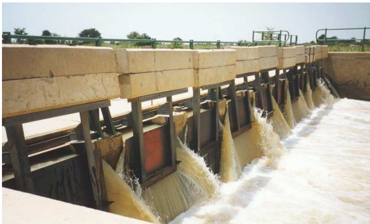
FIG. 2.7: Vannes Begemann du régulateur Furawa du canal de Hadedjia, Nigeria
