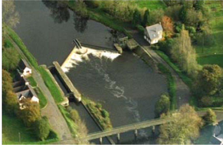
Figure 16 : Photo d'un seuil avec déversoir en "V" de l'Aulne canalisé.
