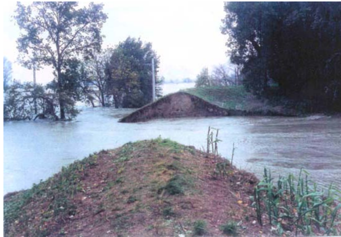
Figure IV.6 : Formation d'une brèche (Digue de Camargue)
