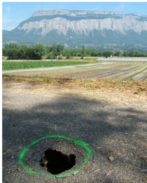
Figure IV.4 : Effondrement en crête de digue lié à la décomposition d'une souche (Digue de l'Isère)
