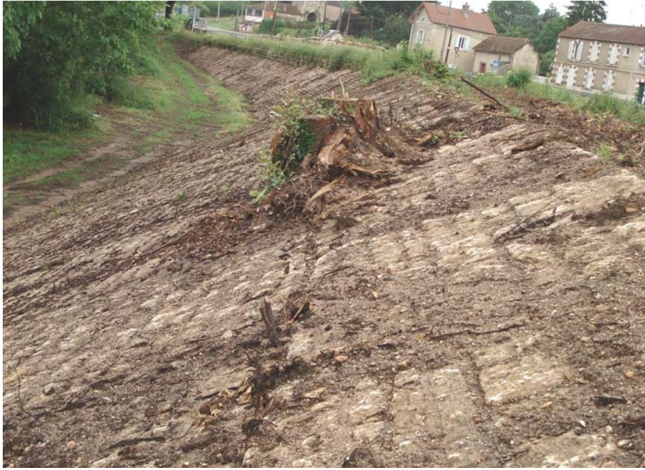
Figure IV.1 : Colonisation par des racines d'arbre d'un joint ouvert de perré maçonné - amorces de déstructuration (Levée de la Loire)
