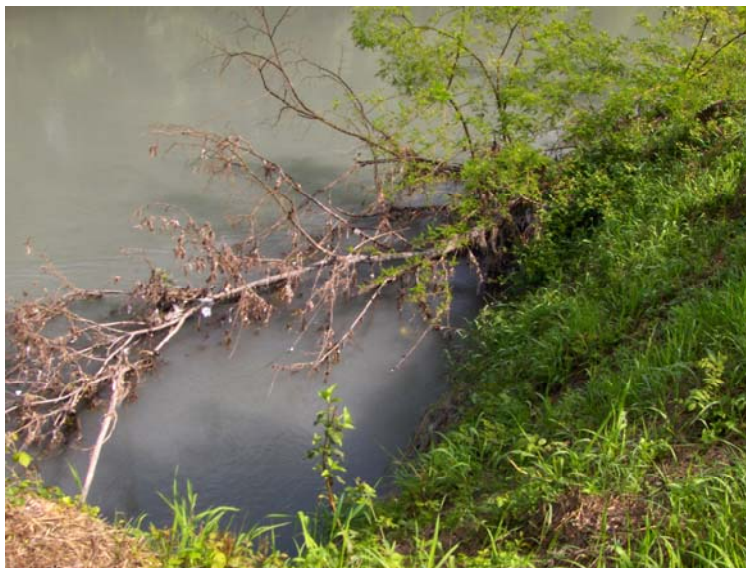
Figure IV.8 : Affouillement du pied de digue par des courants tourbillonnaires (Digue de l'Isère)
