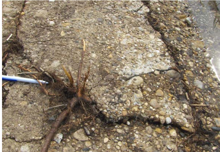
Figure IV.3 : Dégradation du perré par colonisation d'une fissure par les racines (digue de canal du Rhône)
