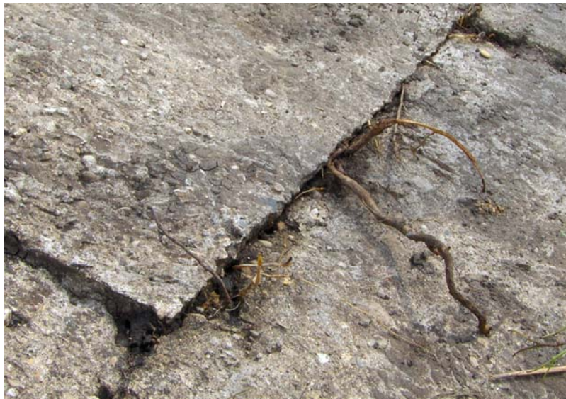
Figure IV.2 : Colonisation par les racines d'un joint de perré bétonné (Digue de canal du Rhône)
