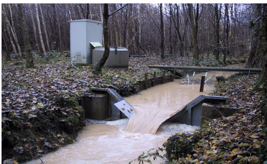
Figure I.7 : Station de mesures au fossé d'évacuation, exutoire du bassin versant de Goins (Ru de Choqueuse)
