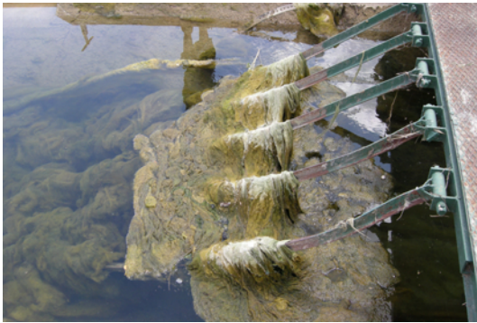
(a) Dégrilleur encombré, canal de Gignac
