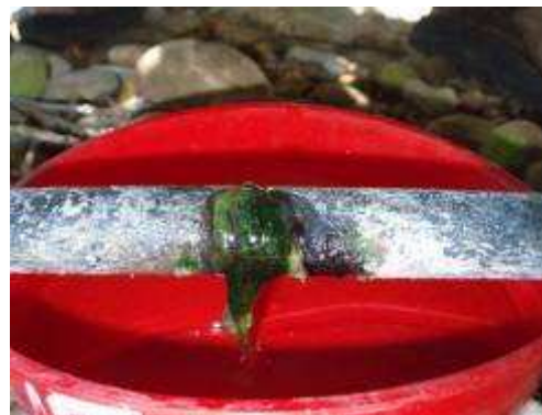
Figure I-17 : Obstruction par des algues de l'orifice de sortie d'un goutteur
