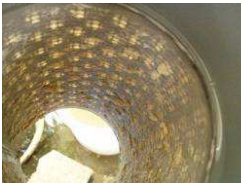
Figure I-16 : Colmatage biologique du filtre en amont de la rampe d'irrigation
