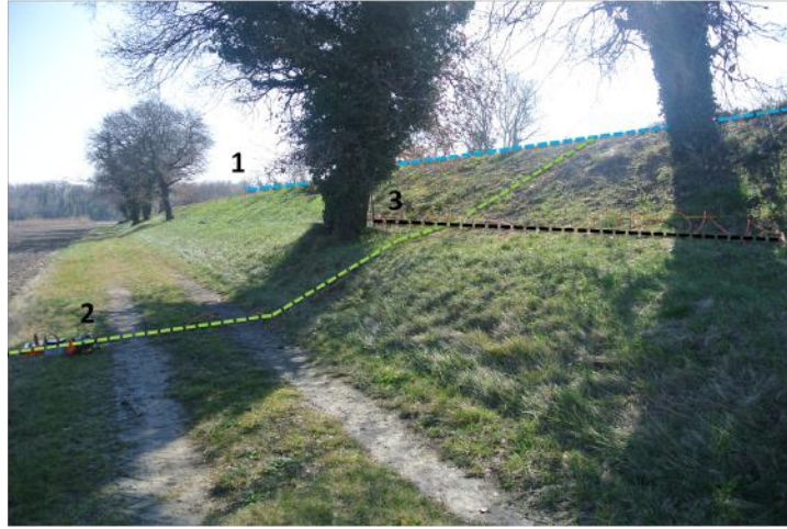
(b) Surperposition des positionnements des profils à la photographie de la digue.
