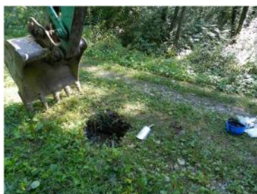
(a) Fontis sur une crête de digue résultant de la probable décomposition d'une grosse souche pour cette digue située en environnement boisé (Photographies : P. Mériaux)
