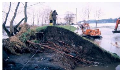
(c) L'érosion de cette digue du Danube, lors des crues de 1988, révèle des racines venant des arbres visibles à gauche, et ayant traversé le remblai de part en part à la recherche de l'eau du côté rivière. On notera le fort diamètre d'une des racines relativement à celui des troncs. Le déracinement d'arbres proches de la crête a été à l'origine de plusieurs brèches au cours de cette crue
