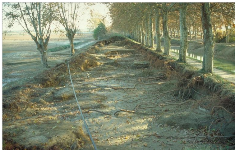
Figure 16. Développement de racines à l'interface du remblai-fondation du canal de Cuxac favorables à une érosion de contact (photo : Mériaux P.)
