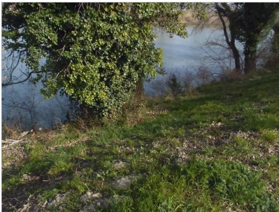
Figure 78. Gros peuplier présent sur le tronçon homogène évalué vis-à-vis du mécanisme de détérioration par érosion interne de la digue rive droite du Petit Rhône, secteur Mas Marignan (photo : Bambara G., 2015)
