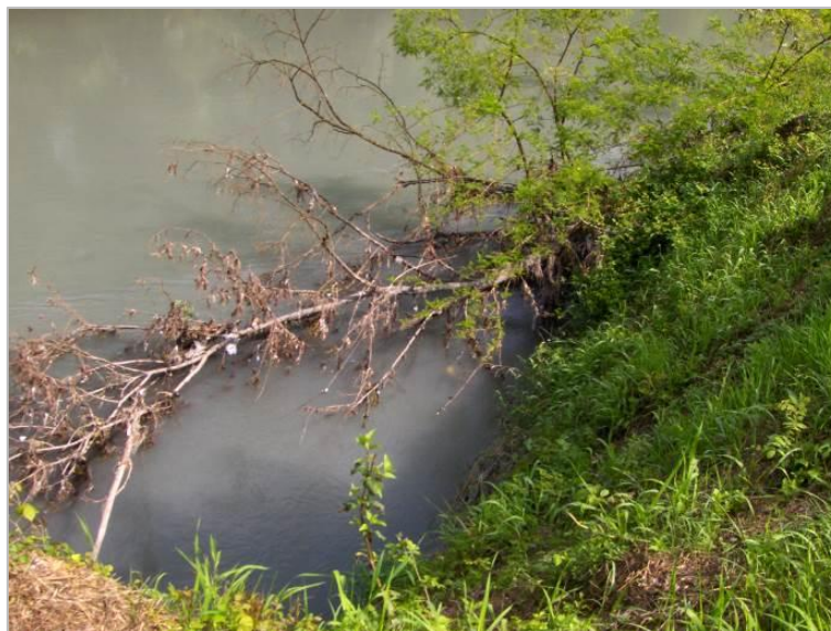
Figure 17. Affouillement du pied d'une digue par les courants tourbillonnaires derrière un arbre tombé (photo : Zanetti C.)
