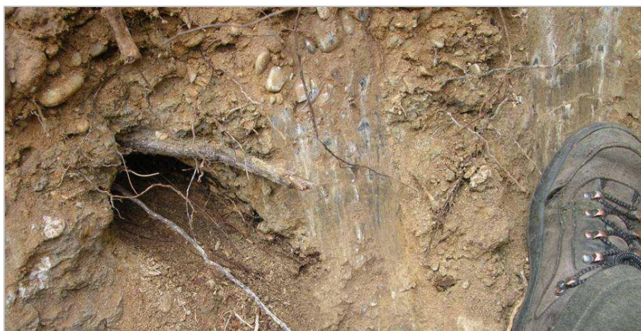
Figure 13. Exemple de conduit laissé par une grosse racine ligneuse après sa décomposition sur un ouvrage (photo : Zanetti, C.)
