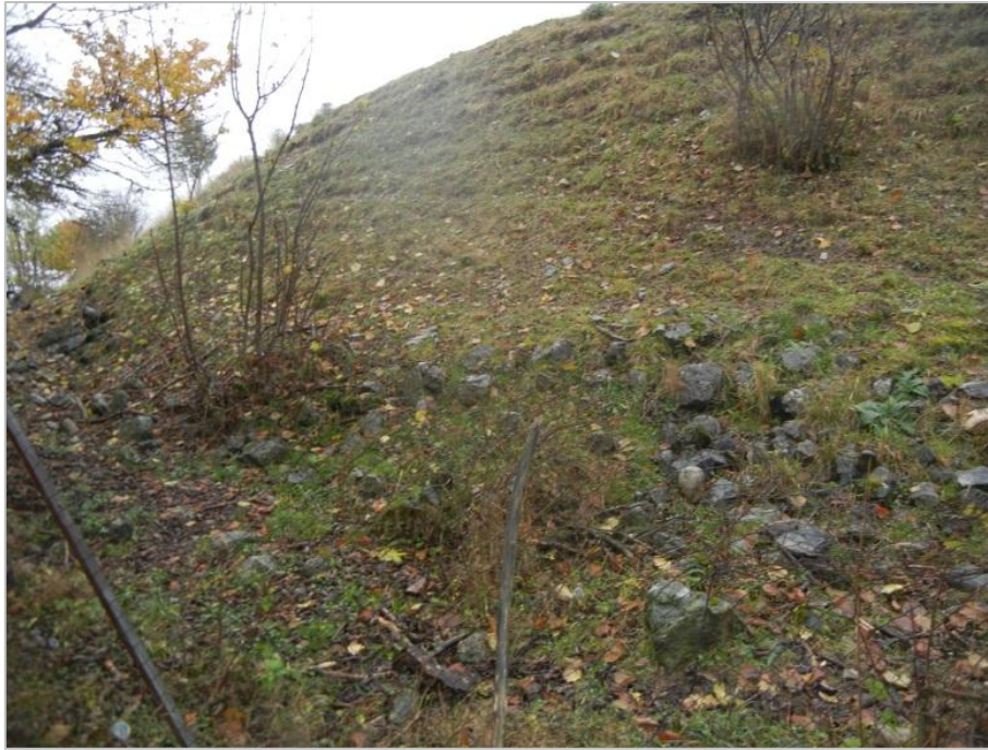
Figure 124. Tapis drainant en pied aval du barrage des G... (France – 05) (photo : Bambara G., 2014)
