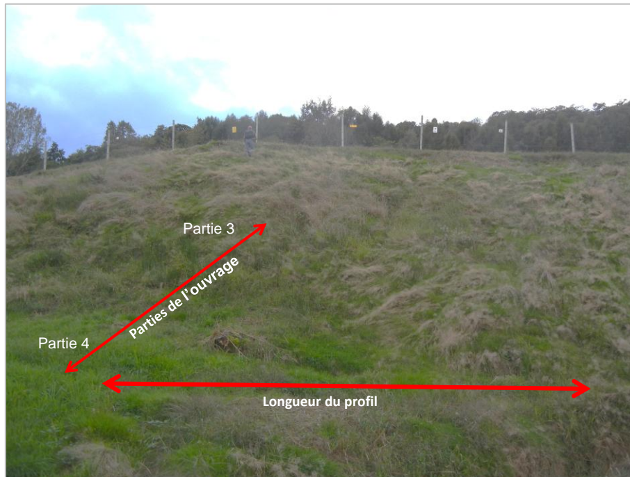
Figure 116. Profil choisi par le groupe d'experts pour l'évaluation de la performance du barrage d'O...vis-à-vis du mécanisme d'érosion interne (photo : Bambara G., 2014)
