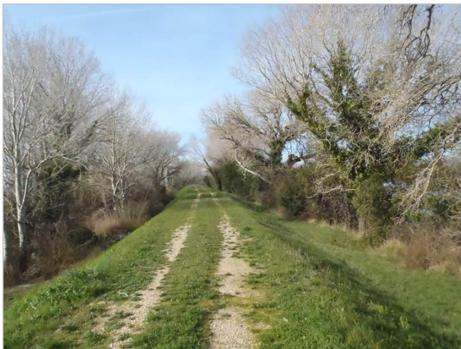
Figure 76. Photo de la digue rive droite du Petit Rhône dans le secteur du Mas Marignan, bordé de végétation arborescente à chaque pied de l'ouvrage (photo : Bambara G., 2015)
