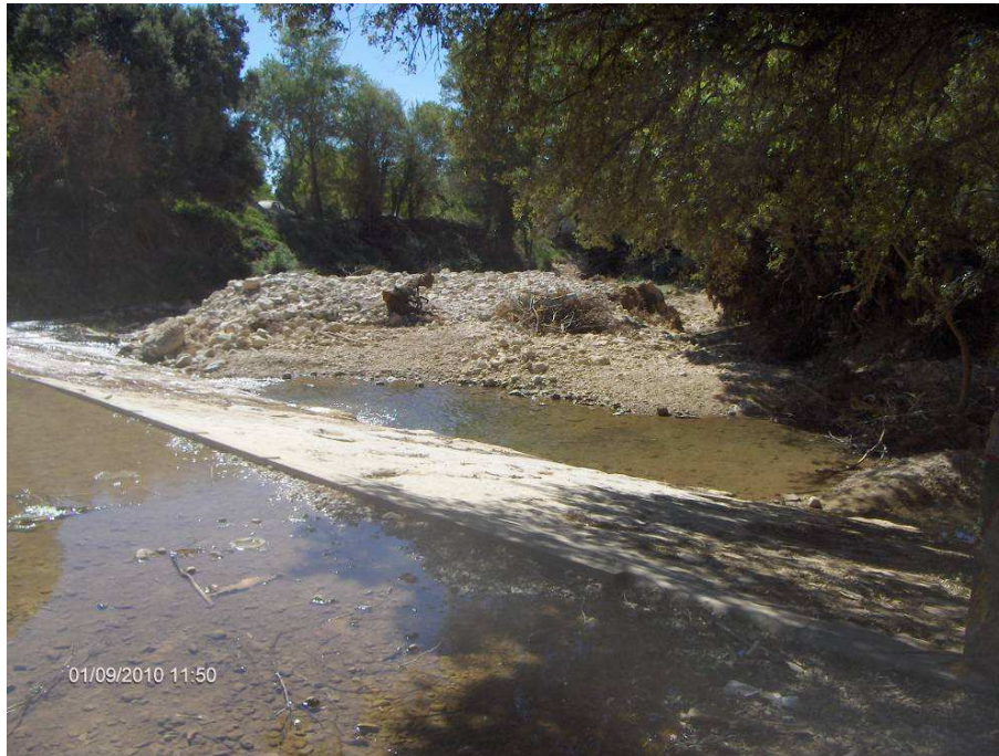
Figure 7-34 —Le seuil sur la Nartuby dans le lit mineur sur le site de la Clappe. On a mesuré une hauteur d'eau au dessus du seuil de 2.2 m sur une largeur de 34 m avec un coefficient de réduction compris entre 0.43 et 0.48. Le débit estimé en lit mineur est compris 211 m 3 /s et 236 m 3 /s.
