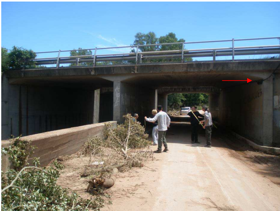
Figure 7-30 –Le pont de l’autoroute de l’A8, la flèche rouge indique le niveau de l’eau lors de la crue.
