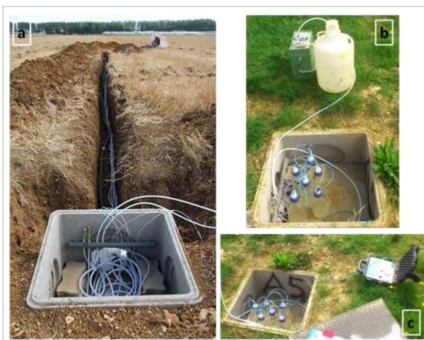
Figure II.22- Collecte de l'eau du sol : (a) regard en béton en cours d'installation en bordure de parcelle à 15-20 m de la fosse, (b) pompe péristaltique et bidon de 23 L pour la collecte de l'eau provenant des bidons enterrés connectés aux lysimètres, et (c) pompe à vide pour la mise en succion des 6 bougies poreuses au moyen des flacons collecteurs de 1 L.
