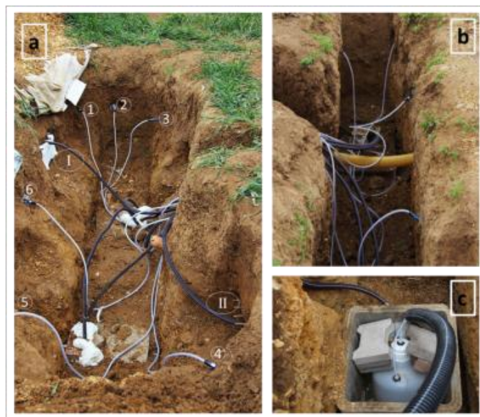
Figure II.2112- Installation des équipements de collecte d'eau : (a) fosses d'installation des lysimètres à mèche et bougies poreuses (1 à 6 bougies poreuses et I à II lysimètres à mèche), (b) drain au milieu de la fosse, et (c) bidon de 23 L pour collecter l'eau provenant du lysimètre placé dans un regard en béton.
