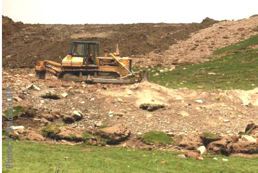
Figure 1 : destruction du couvert végétal suite à l'aménagement d'une piste de ski
