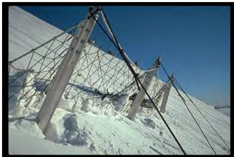
Figure 2.13 : Filets paravalanches retenant la neige dans la zone de départ
