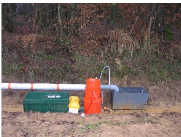
Figure 35 : Dispositif de mesure des débits d'eau en sortie du réseau de drainage et d'échantillonnage automatique
