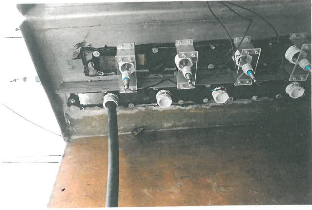
Photo L-3 : installation du Vertiscope : capteurs horizontaux et dispositif de réglage du niveau de la nappe fissurale, Gardel-INRA.
