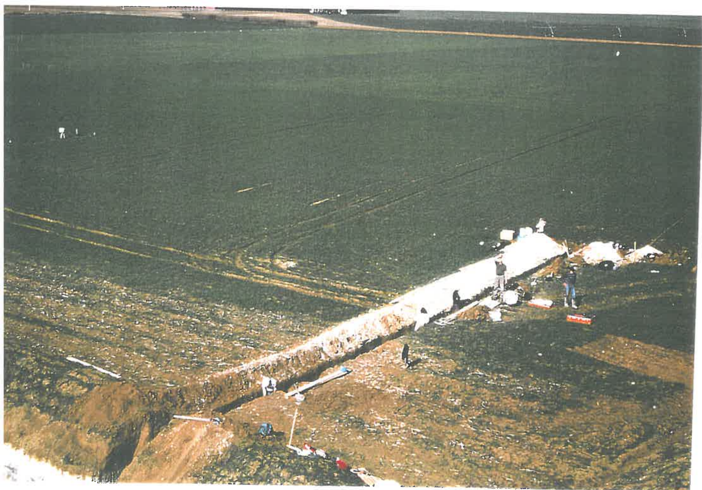
Figure 3.2 : Vue d'ensemble de l'allure générale de la surface du sol dans le secteur d'étude.
